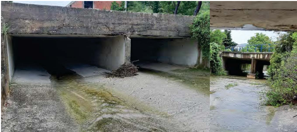
Slika 2.2-11 Taranta – Točka 1 (lijevo) - ulaz u natkriveni dio nizvodno od magistrale (pogled nizvodno) i (desno) pogled uzvodno na otvorenu dionicu i propust ispod magistrale
