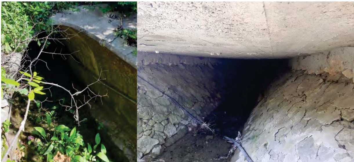
Slika 2.2-13 Žujinac – Točka 3. (lijevo) propust ispod magistralne ceste (pogled uzvodno) i (desno) natkrivena dionica nizvodno od propusta (pogled nizvodno)
