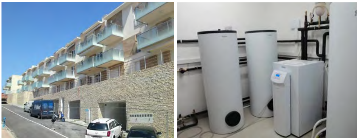
Slika 225. Višestambeni objekt Pazdigradska ulica, Split i unutrašnjost strojarnice
