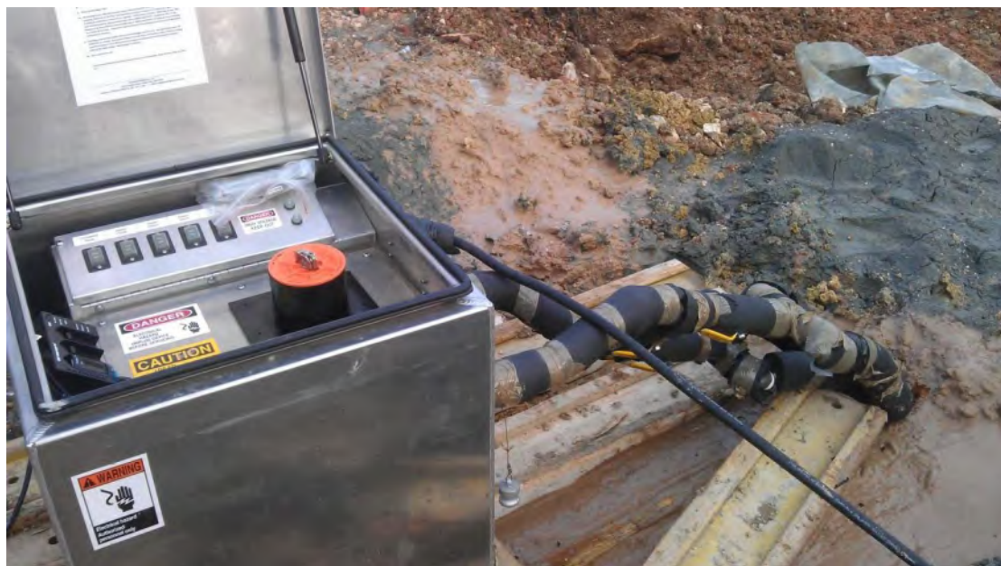
Slika 230. Izvođenje testa toplinskog odaziva (TRT) tijekom radova na instalaciji bušotinskog polja na lokaciji Stara Novalja, Studeni 2012.
