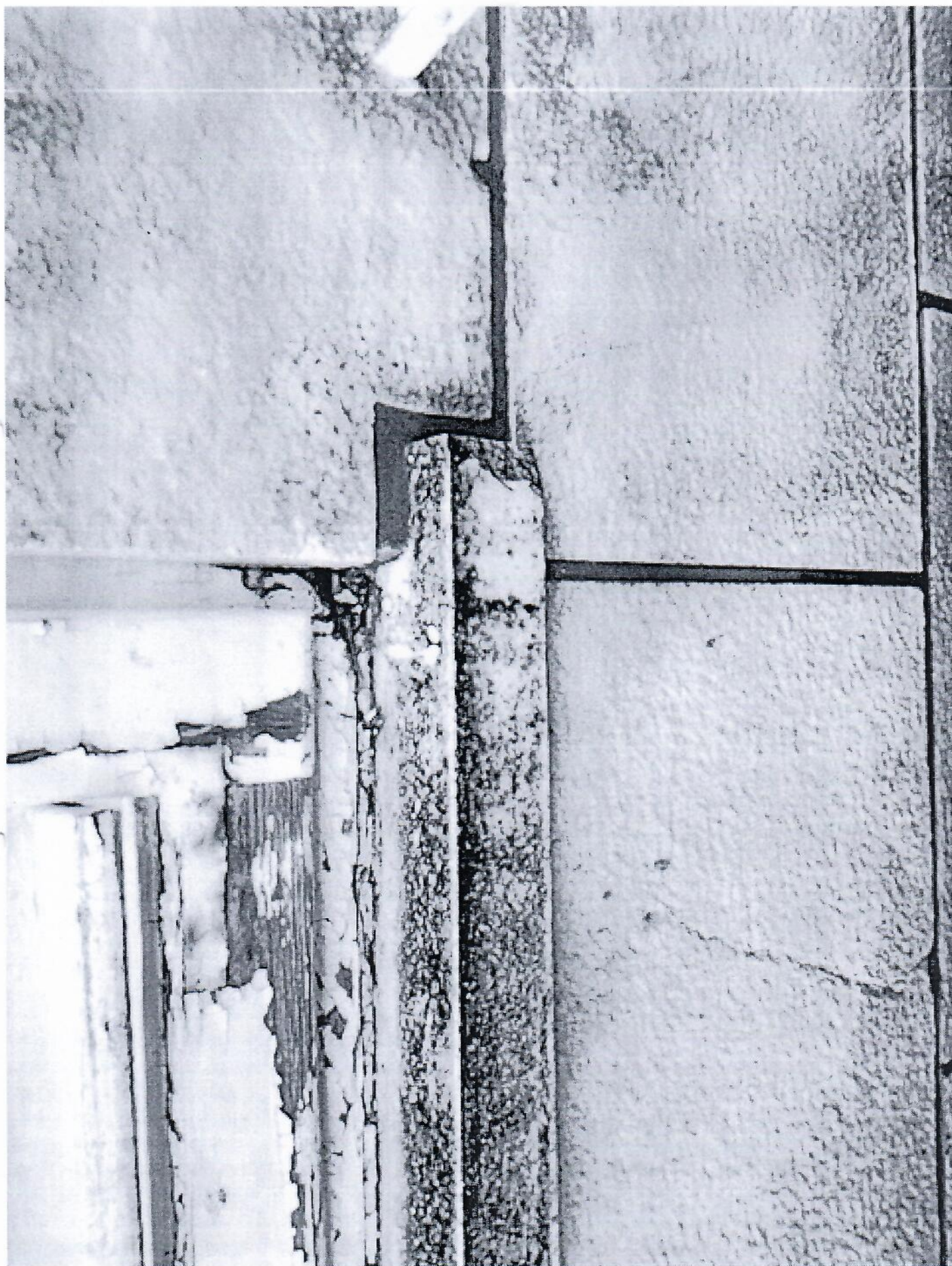
OŠTEĆENA PROZORSKA STOLARIJA I ZAPUŠTENA VANJSKA PROZORSKA KLUPICA
